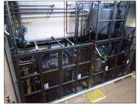
Turn-Key-Cip-Anlage: auf engstem Raum maßgeschneidert am Platz der Altanlage untergebracht (Bild: Ing.-Büro Täschner)
